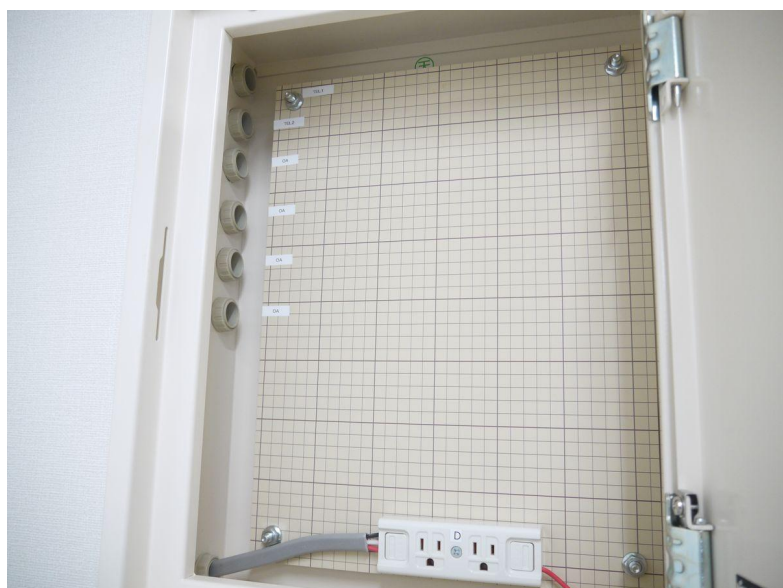
事務室 端子盤
