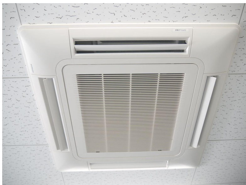
事務室 エアコン
