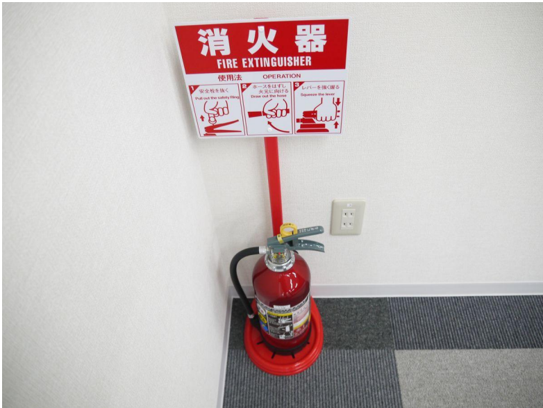
事務室 消火器
