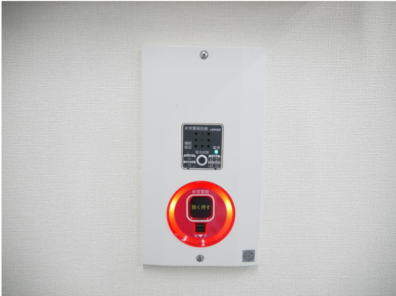
事務室 非常警報装置
