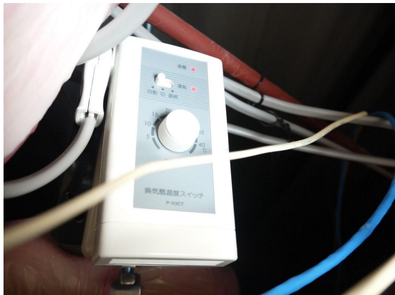
事務室 天井内温度センサー
