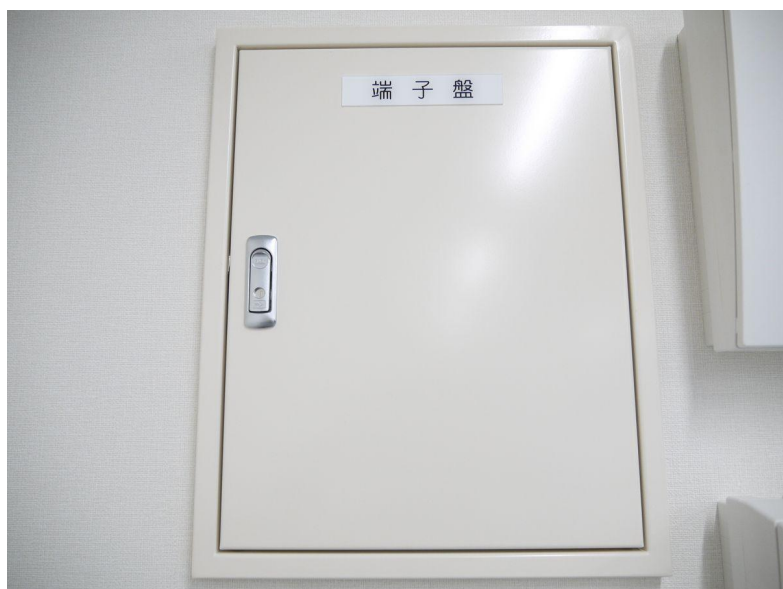
事務室 端子盤
