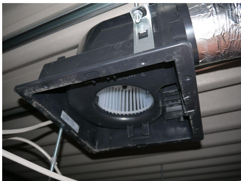
事務室 天井内換気扇
