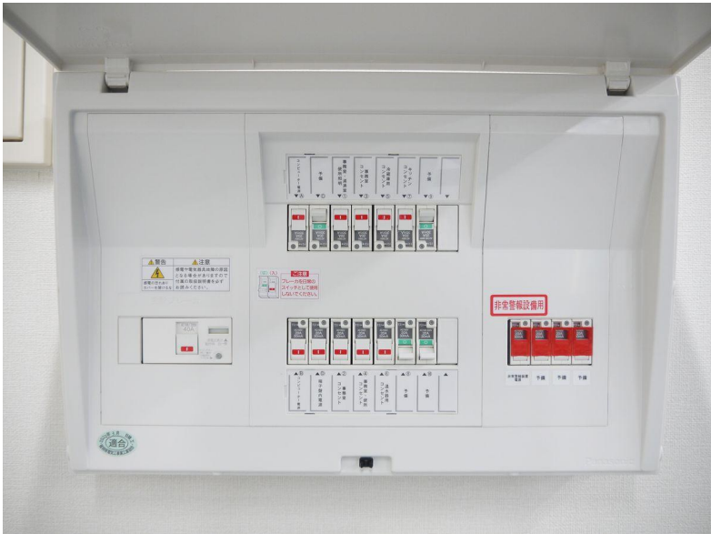
事務室 電灯分電盤
