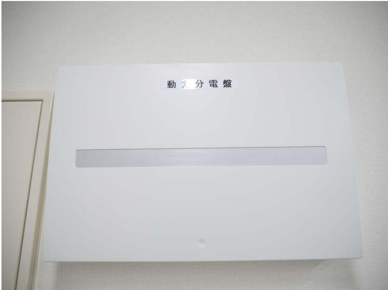
事務室 動力分電盤
