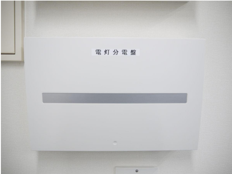
事務室 電灯分電盤
